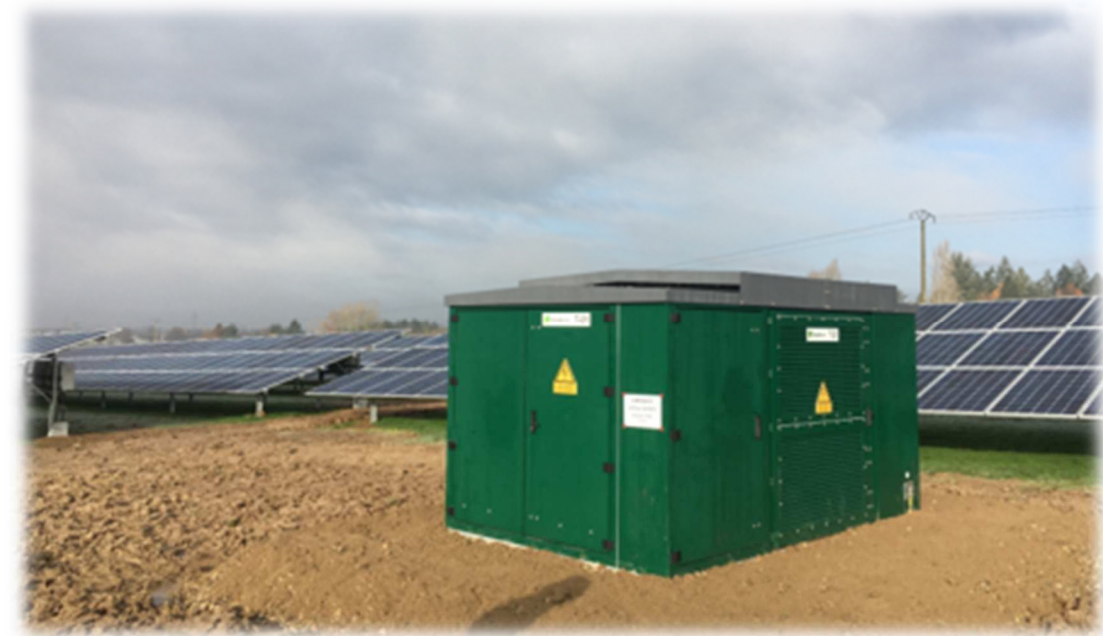
Poste de transformation
